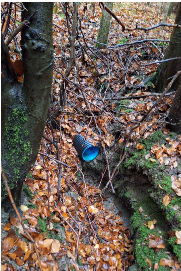
Figur 3-3. Rørunderføring inden for projektområdet. PVC-rør som denne opgraves og bortskaffes. Foto taget den 29.10.2024.
